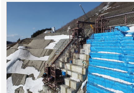
【SP-TOM&ベルトコンベア】 今年度はSP-TOMとベルトコンベアを用いてCSGプラントから堤体まで約1kmの区間のCSG材の連続搬送を実施します。
